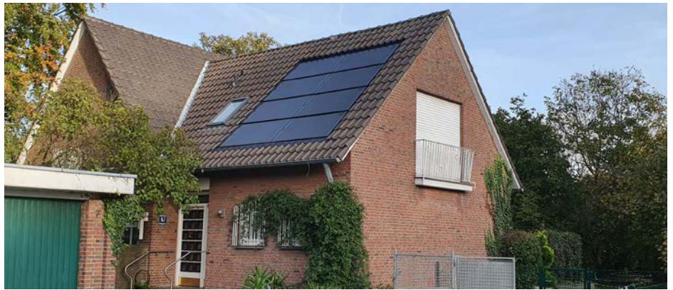
Die Vorgaben der Denkmalschützer wurden erfüllt: Das Solarfeld schmiegt sich unscheinbar in die Ziegeleindeckung.
